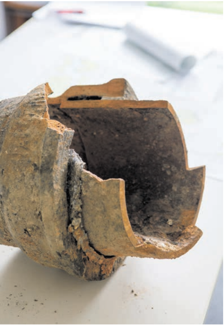
So manche Rohre haben schon bessere Tage gesehen. Glatte Schläuche werden sie fließfähig machen.
