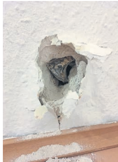
Wanddurchbruch im Flur. Eine von vielen Überraschungen.
