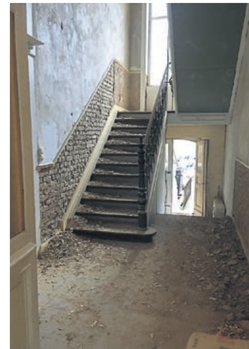
Nackte Wände als neuer Normalzustand im mit Schutt und Staub eingedeckten Treppenhaus.
