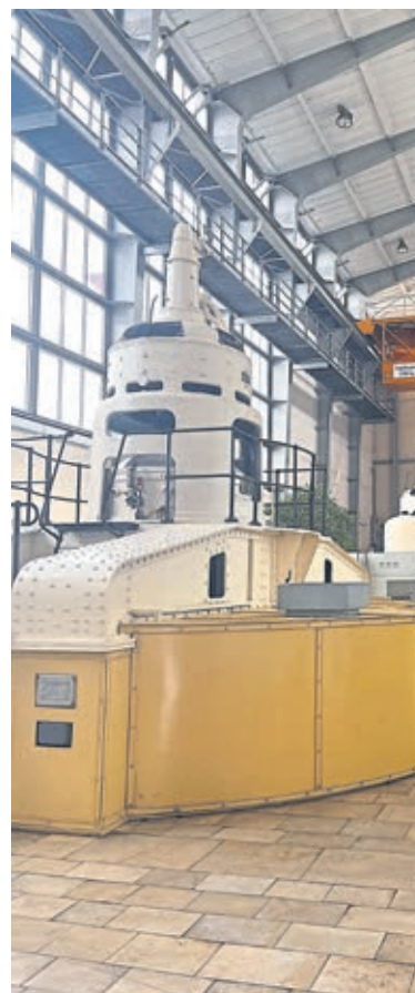
Wasserkraftwerk Griesheim; Foto: KulturRegion/CharlotteKleine
